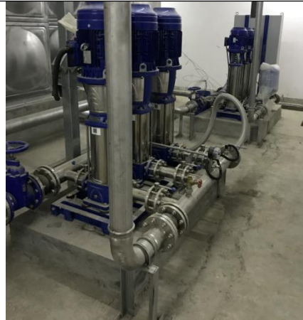
水泵房减振基座
